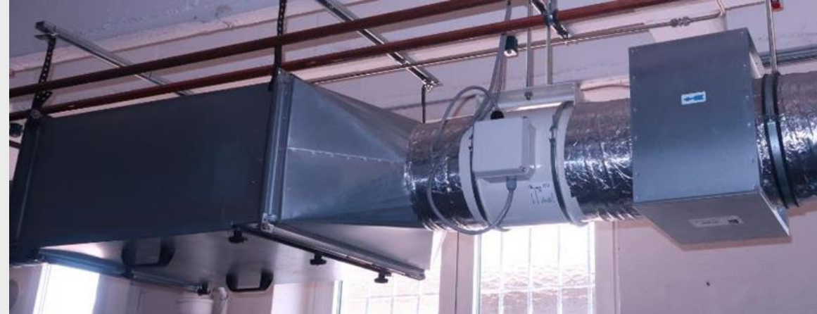
Abb. 12: Luft-Feinfilter, Rohrventilator und Luft-Vorfilter der Abluftanlage
