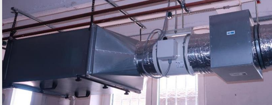
Abb. 12: Luft-Feinfilter, Rohrventilator und Luft-Vorfilter der Abluftanlage
