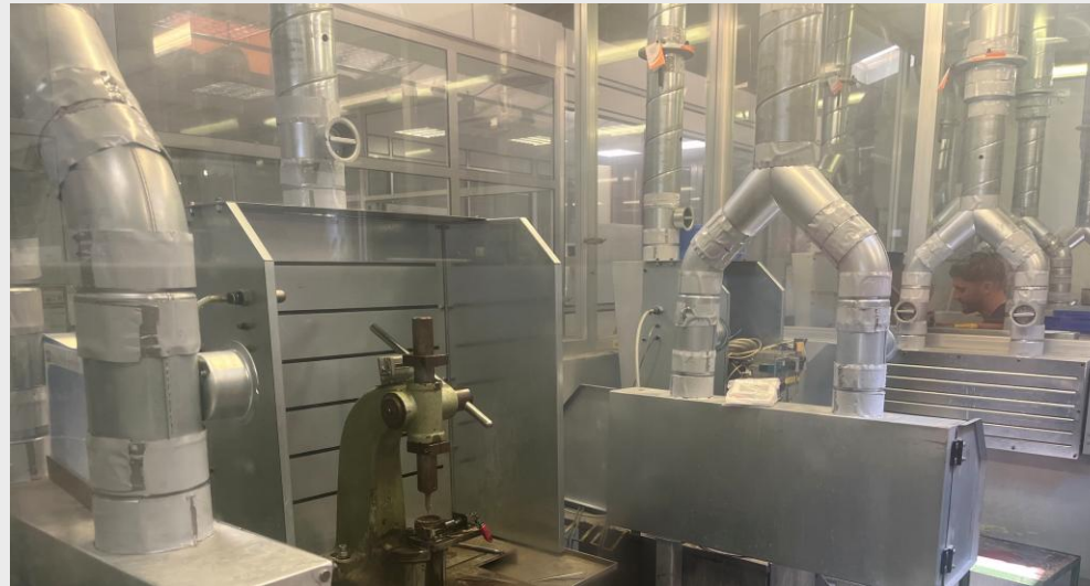
Abb.17: Die neue Absaugungsanlage in Seltz
