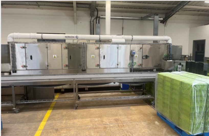
Abb.16: Neue Reinigungsanlage für die Kunststoffkisten in Seltz
