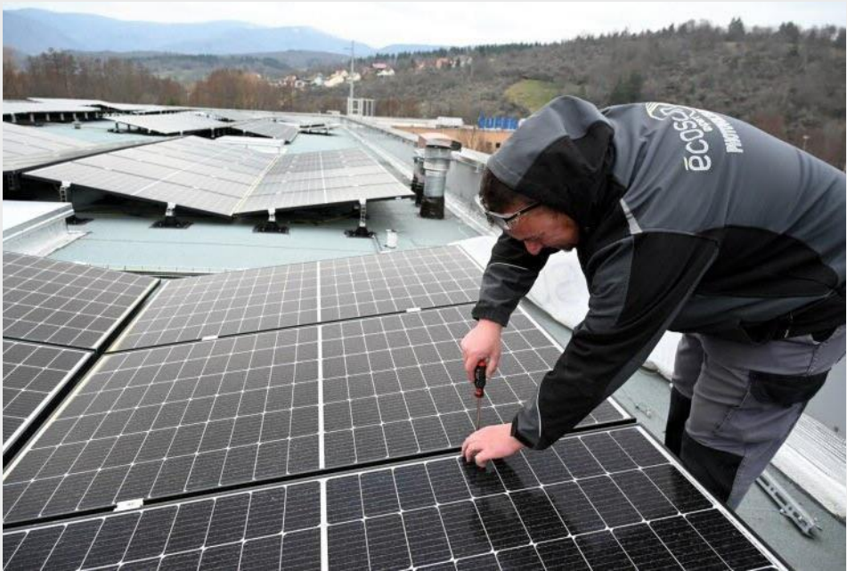
图21: 位于 Villé 的“Energiessen”项目中一家公司大楼上的光伏系统
