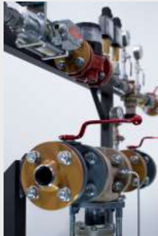
图5: RAY 石油生产线, KVA Delfzijl,荷兰
