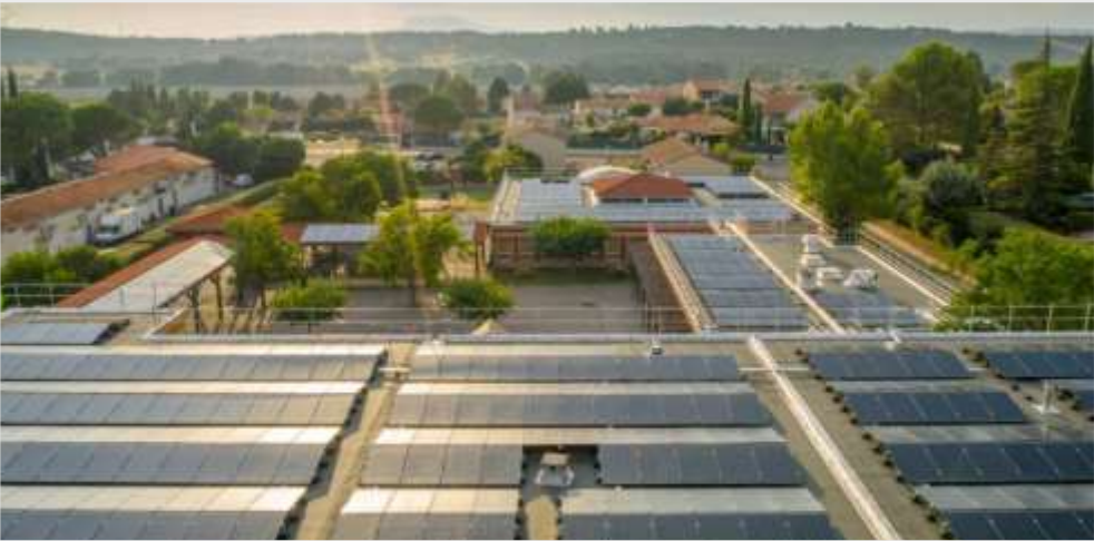
图11: Villé当地“Energiessen”项目一家公司大楼的光伏系统
